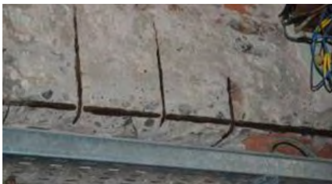
Corrosión de hierros. Desprendimiento de revocos.
