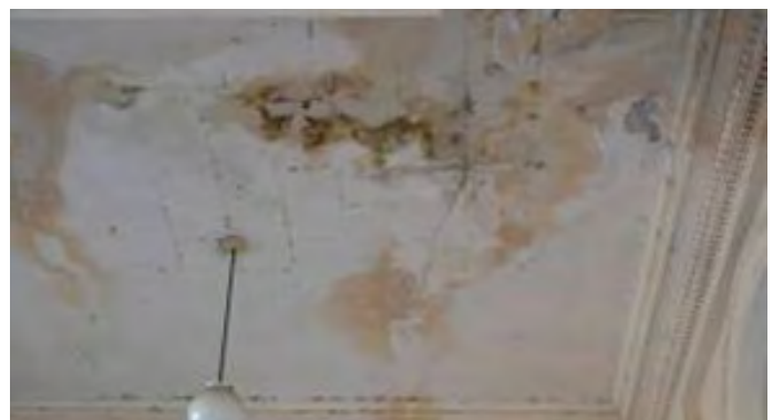
Humedad descendente y manchas (óxido de hierro).
