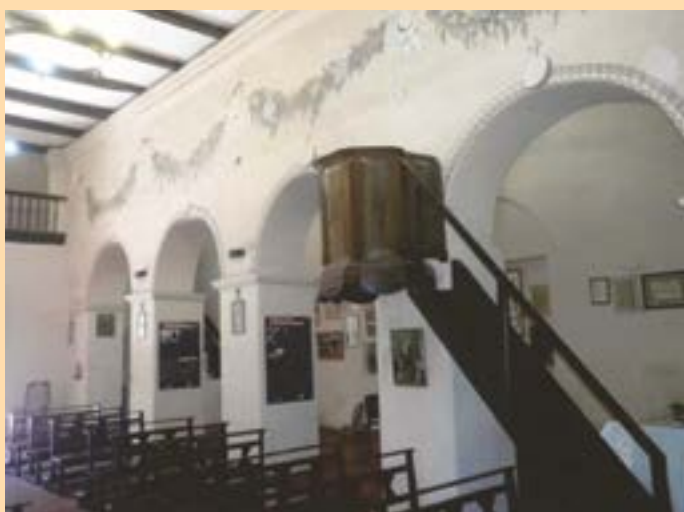
■ Vista del sistema estructural que divide las naves, con el púlpito como elemento protagonista.
